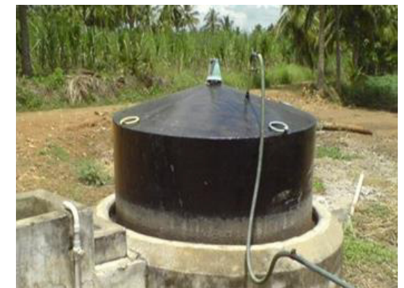
Un réacteur à biogaz en surface; notez le tuyau utilisé pour purger les gaz au sommet de la cuve
